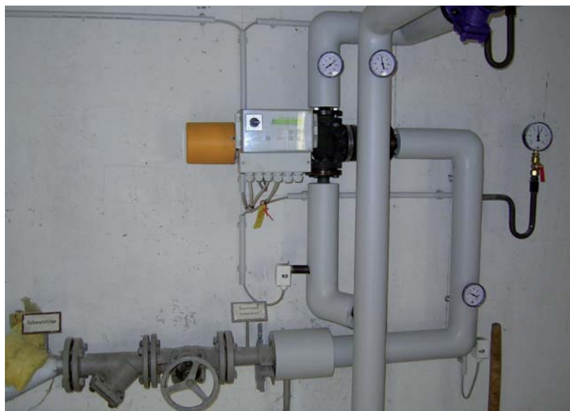
Bild 7: Strahlpumpe mit Regler in einer Nahwärmestation.
