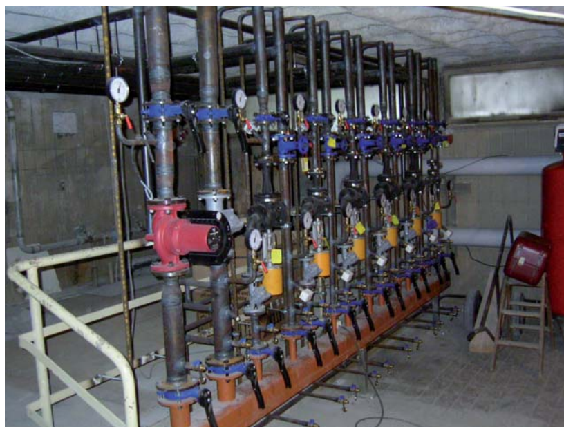
Bild 8: Heizungsverteiler mit Strahlpumpen und einer Hauptpumpe.
